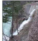
トンネル湧水
