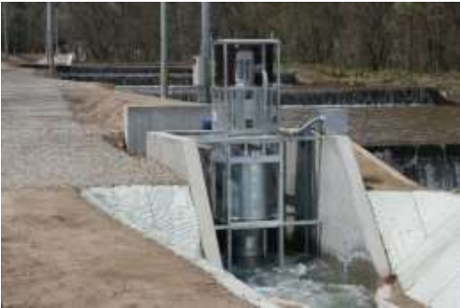
松川小水力発電所
