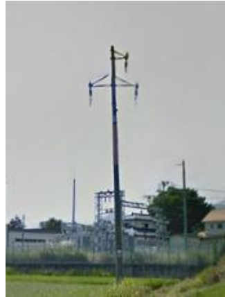
郡山市関森変電所と送電柱
