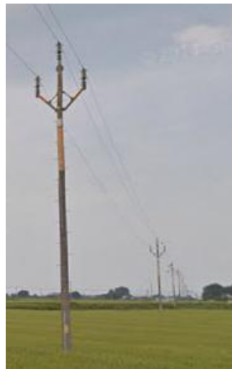
関森線の33000V電柱
