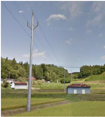
青石水力発電所の送電線
